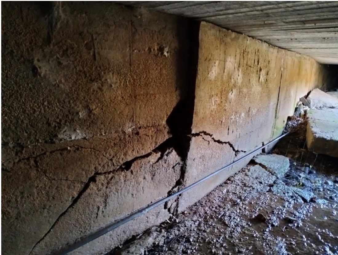
Figura 9 - Inizio collasso parete in sinistra idraulica
