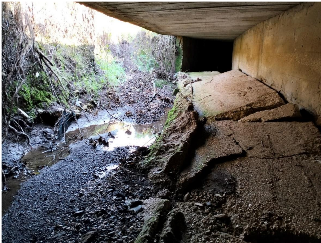
Figura 8 - Crollo parete in sinistra idraulica
